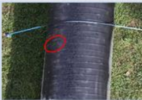
Conduite Forcée (ligne de rouille)
